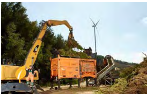
Abbildung: Stationäre Grünabfallaufbereitung
