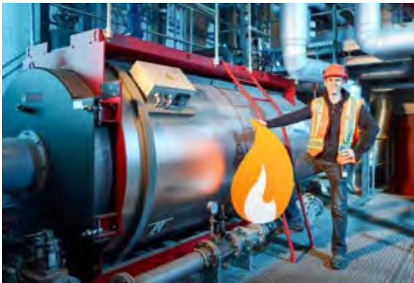
Abbildung: Bosch-Gaskessel im BMHKW
